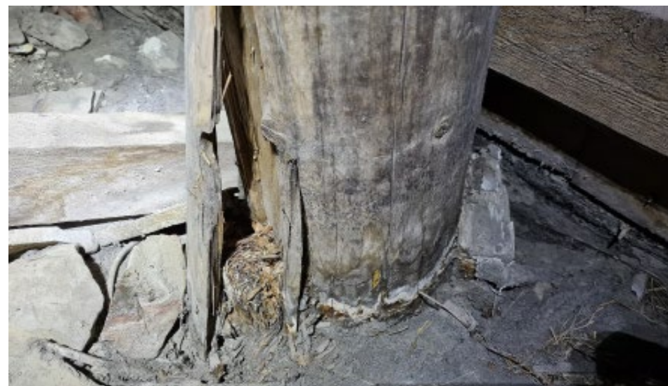
Råte og brudd i trepæler under boligbygg
